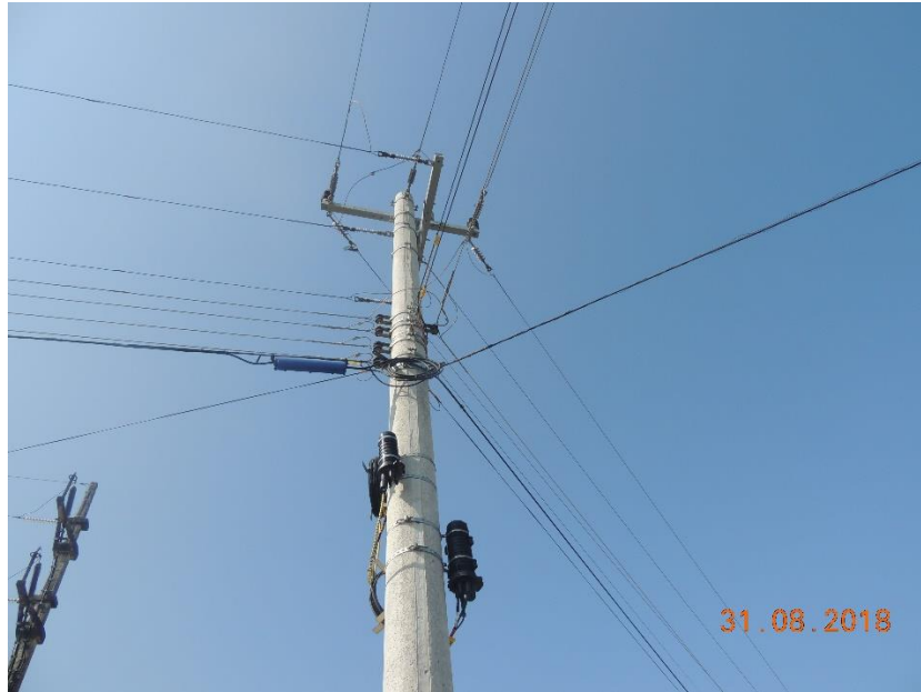
Figura 42: Detalhe das redes de transmissão de energia que passam em frente ao empreendimento. No canto inferior esquerdo da imagem, a rede de altíssima tensão que abastece a PORTONAVE. Ao centro, redes de alta e baixa tensão.
