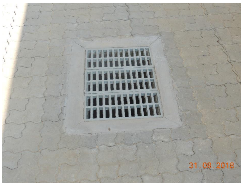
Figura 37: Detalhe de grelha metálica em boca de lobo que compõe o sistema de drenagem pluvial do empreendimento.
