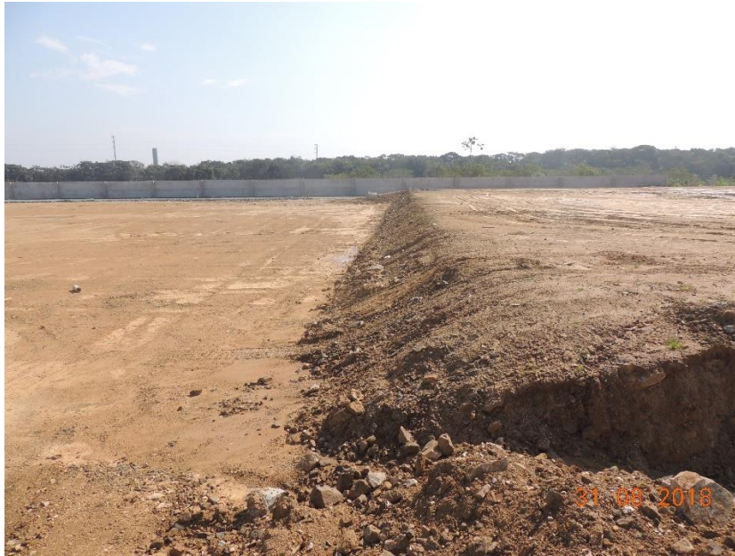
Figura 48: Detalhe da obra de terraplanagem realizada na extremidade Norte do terreno onde será feita a instalação de um dos galpões.
