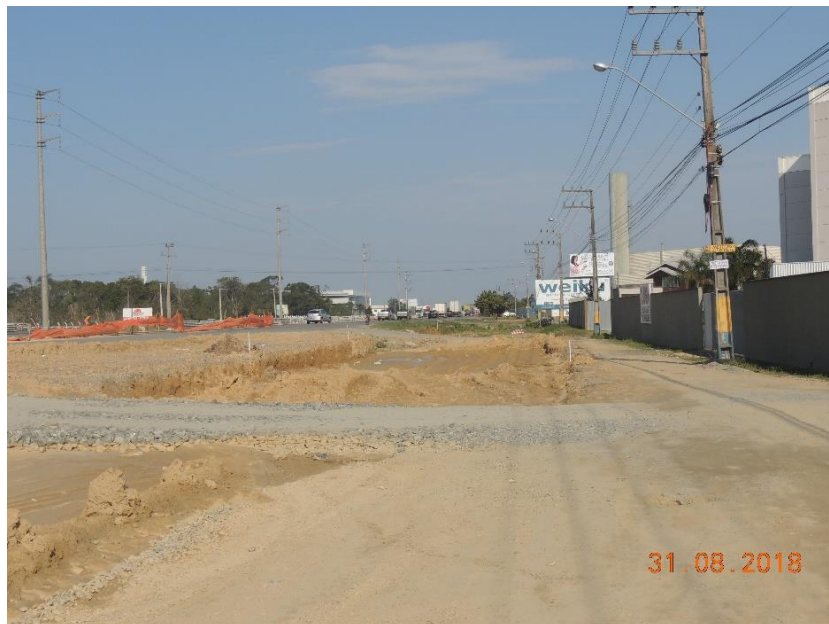
Figura 43: Redes de distribuição de energia e iluminação pública em frente a alguns terminais logísticos e esquinas de ruas interligadas com a Rodovia BR 470. À esquerda rede de altíssima tensão que abastece a PORTONAVE.
