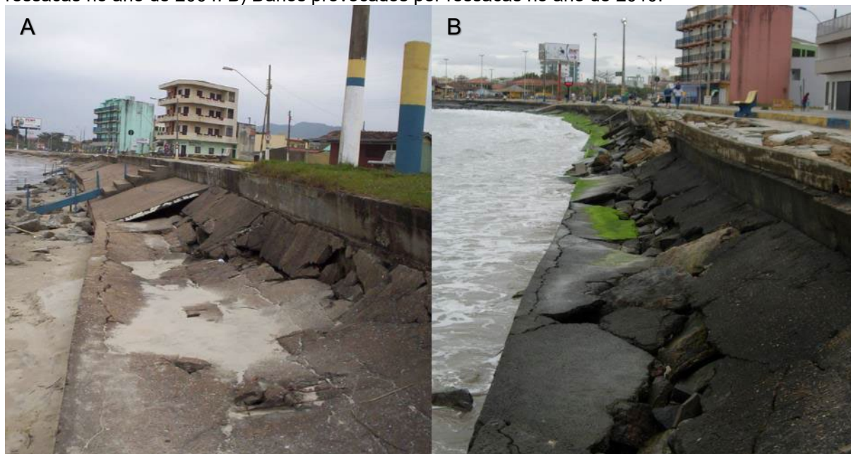
FIGURA 26 – Muro de contenção (sea wall) instalado no ano de 2003. A) Danos provocados por ressacas no ano de 2004. B) Danos provocados por ressacas no ano de 2010.
