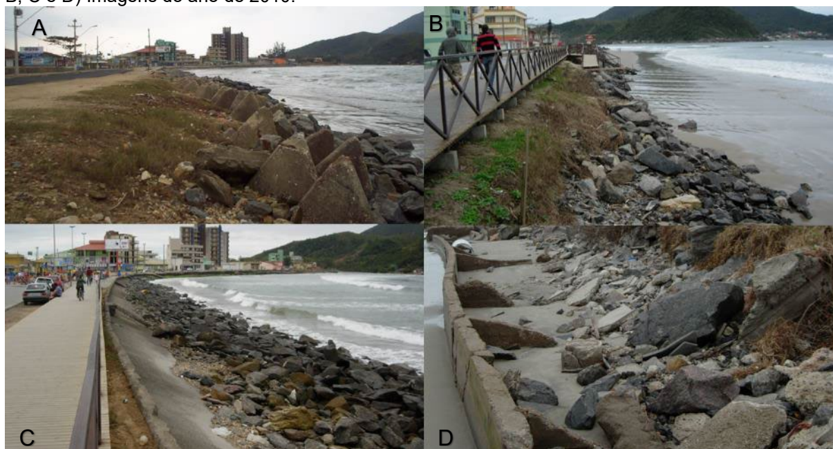
FIGURA 27 – Enrocamento realizado na Praia do Gravatá a partir de 2003. A) Imagem do ano de 2004. B, C e D) Imagens do ano de 2010.
