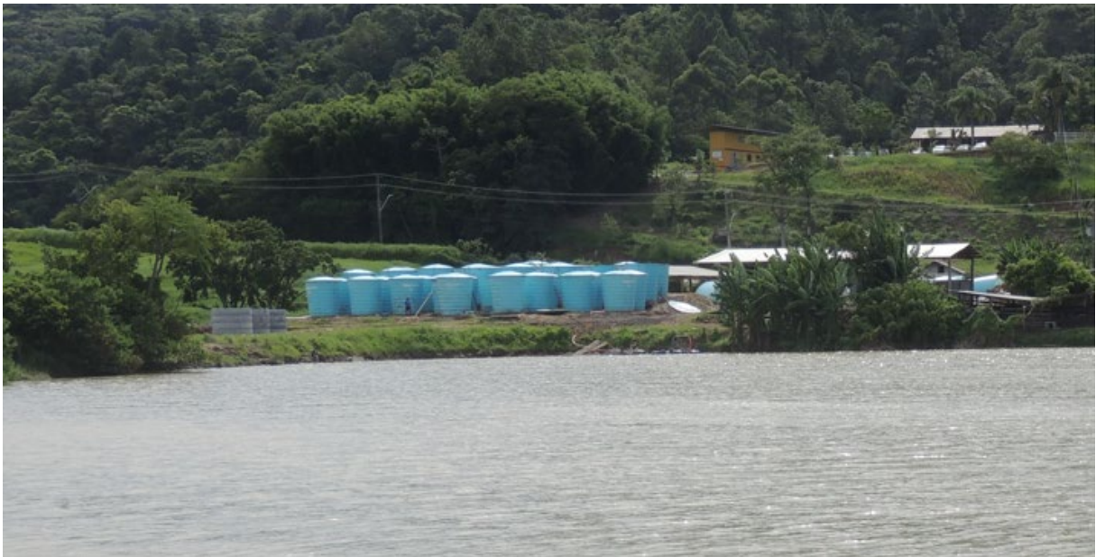
FIGURA 9 – Imagens da Estação de Tratamento de Água (ETA) Pedreiras que abastece os bairros Meia Praia e Gravatá.
