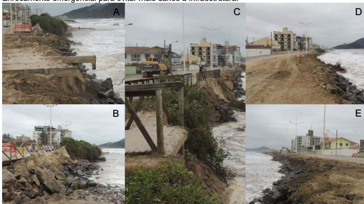
FIGURA 32 – Danos provocados pela ressaca de setembro de 2017. A e B) Danos provocados à estrutura do deck. C) Danos provocados na estreita faixa de restinga remanescente. D e E) Enrocamento emergencial para evitar mais danos à infraestrutura.
