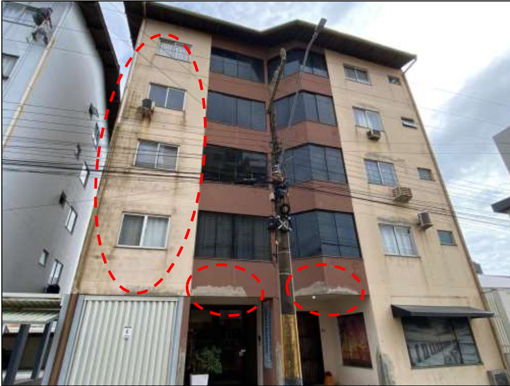
Figura 32: Fachada – manchamentos e fissuras.
