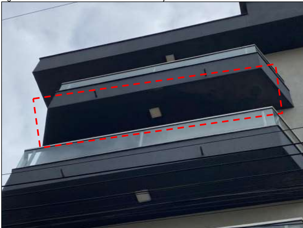
Figura 25: Fachada – sinais de umidade na laje de sacadas.
