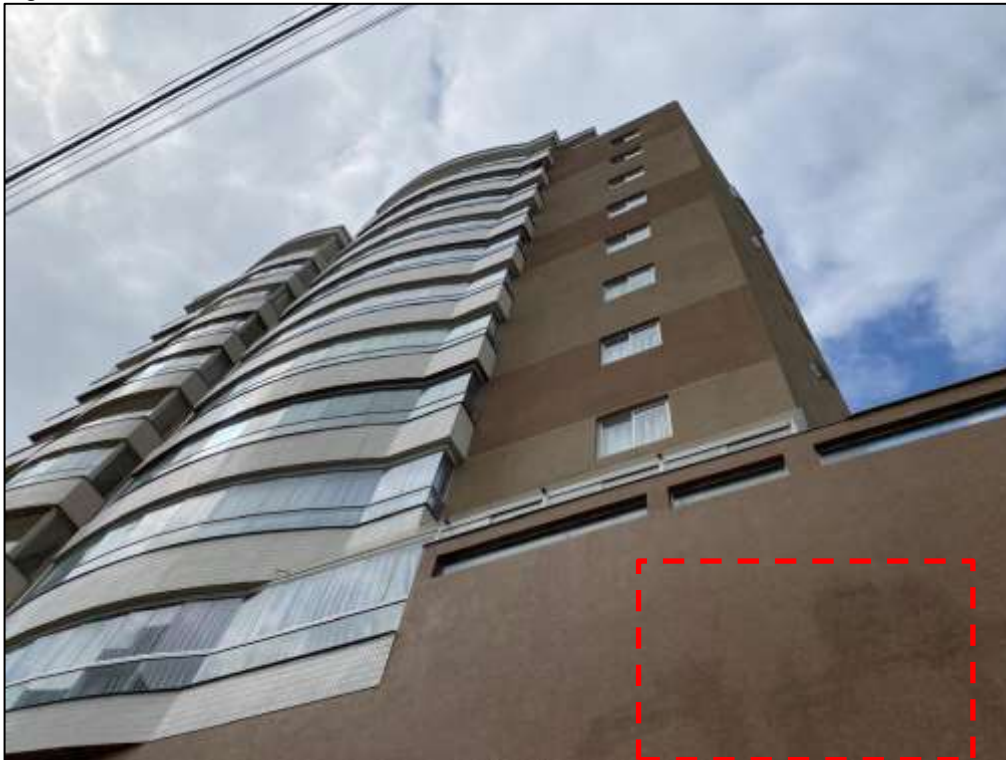
Figura 112: Fachada – sinais de umidade.
