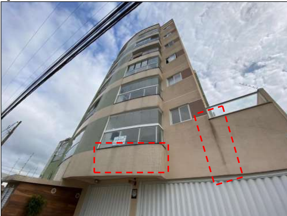
Figura 57: Fachada frontal – manchamentos.
