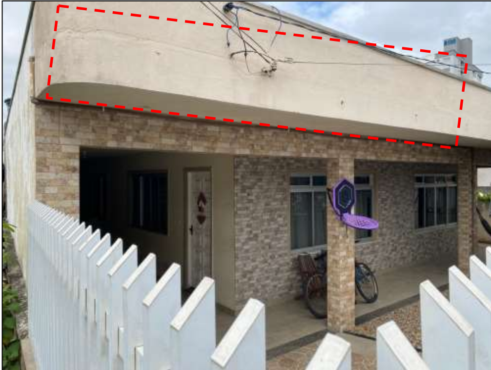
Figura 92: Fachada – fissura platibanda.
