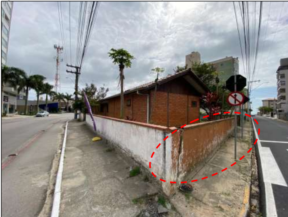
Figura 64: Muro – rachadura e descascamento pintura.
