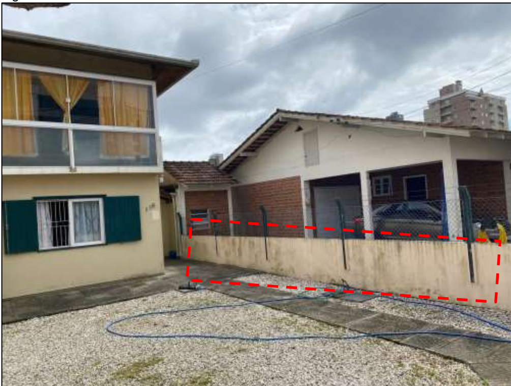
Figura 54: Muro de divisa – manchamento.
