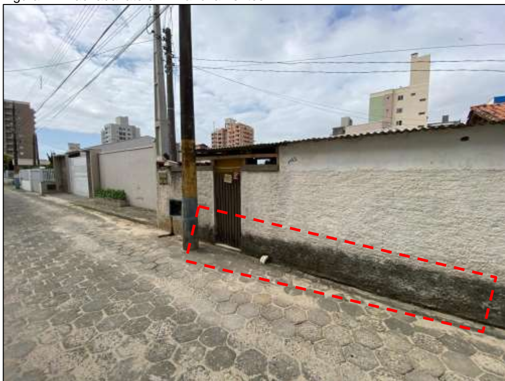
Figura 74: Fachada lateral – manchamentos.
