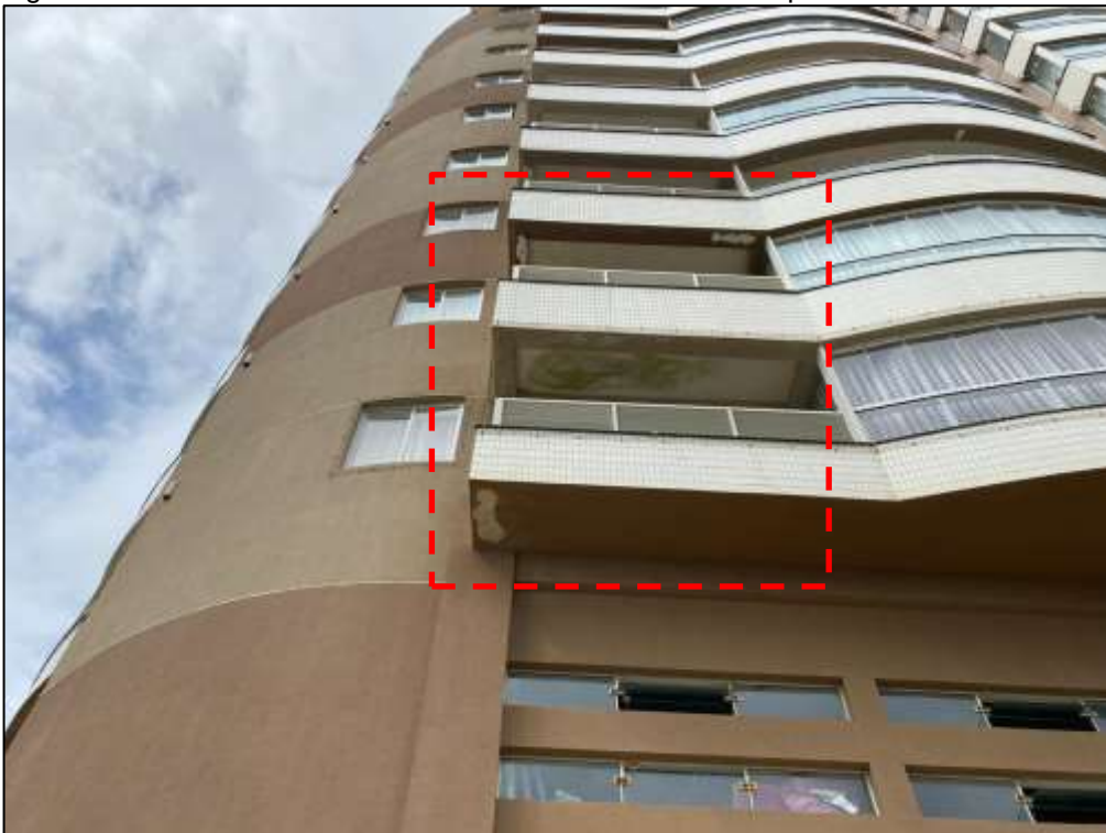
Figura 117: Fachada – sinais de umidade e descascamento pintura.
