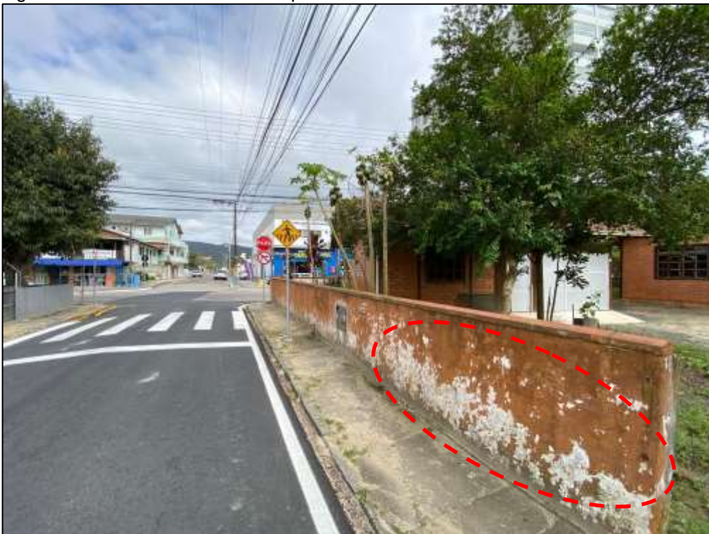
Figura 70: Muro – descascamento pintura.
