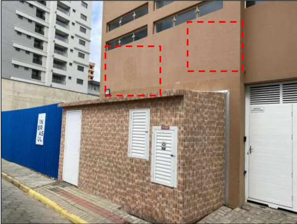
Figura 122: Fachada – sinais de umidade e bolhas na pintura.
