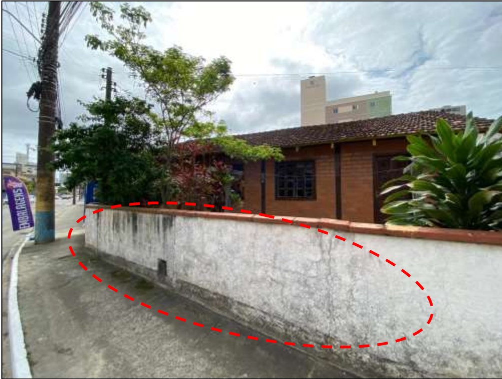
Figura 67: Fachada – fissuras muro e manchamento.
