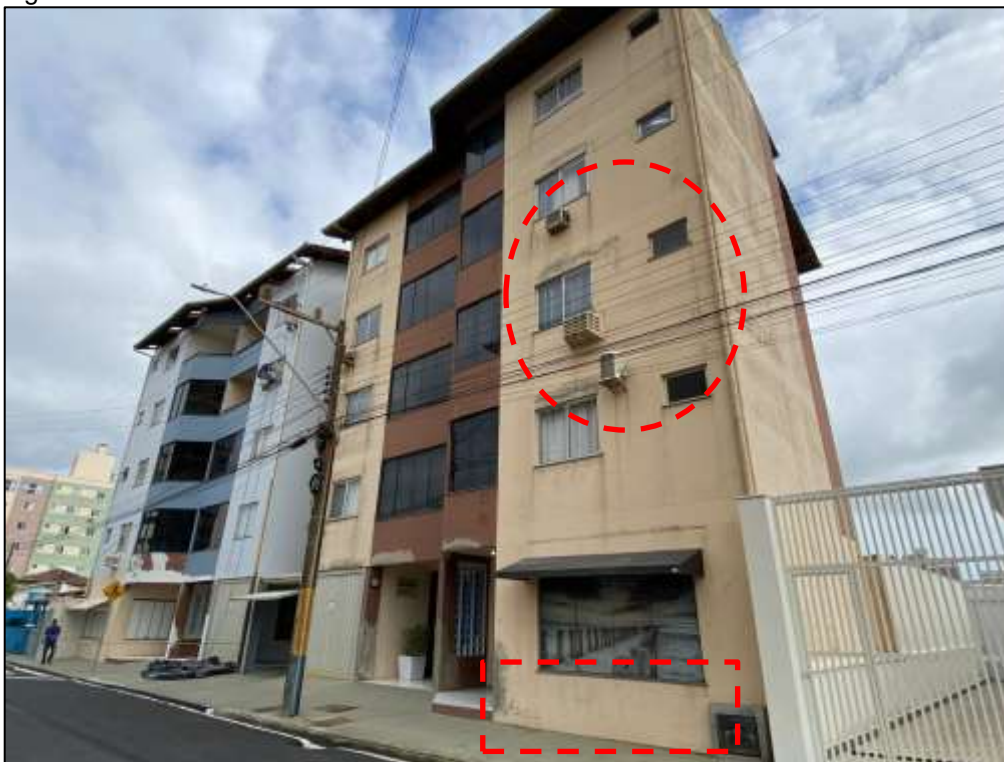
Figura 27: Fachada – manchamentos e fissuras.
