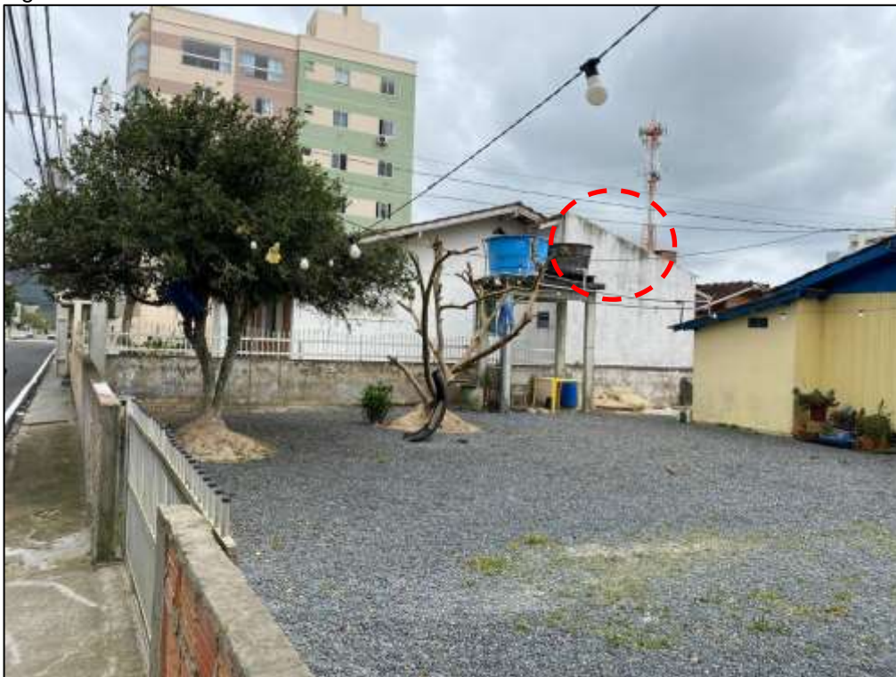
Figura 51: Fachada lateral – manchamento.
