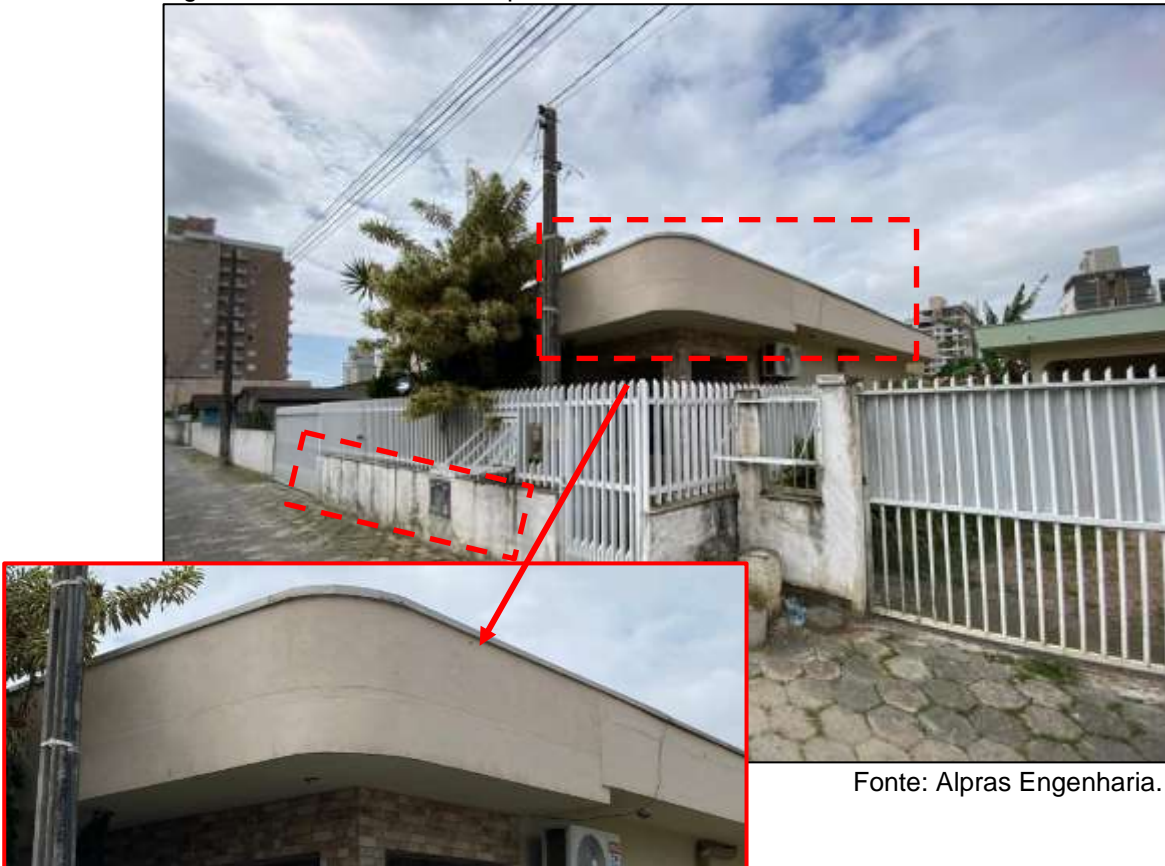
Figura 91: Fachada – fissura platibanda e manchamentos.
