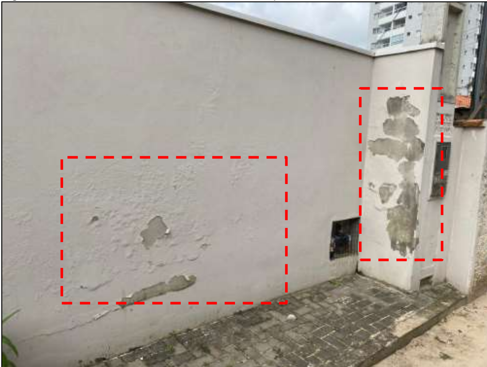
Figura 84: Fachada – bolhas e descascamento pintura.
