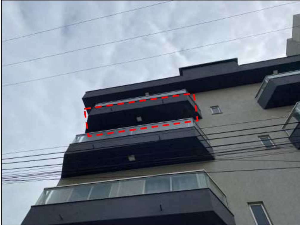
Figura 24: Fachada – sinais de umidade na laje de sacadas.
