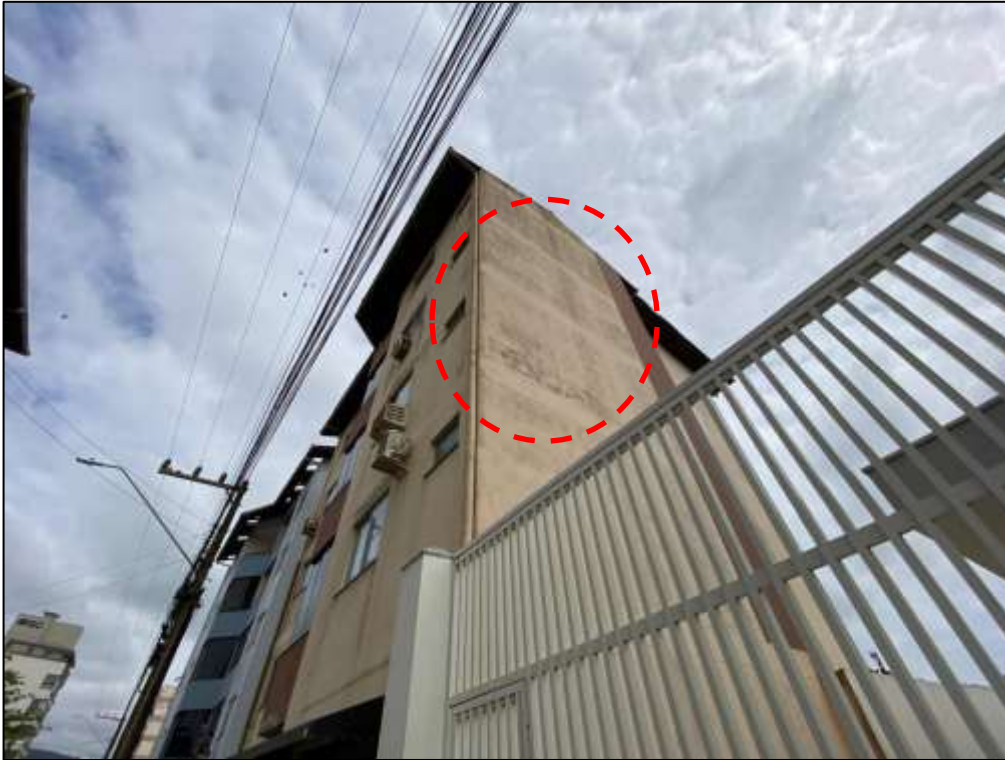
Figura 28: Fachada – manchamentos e fissuras.
