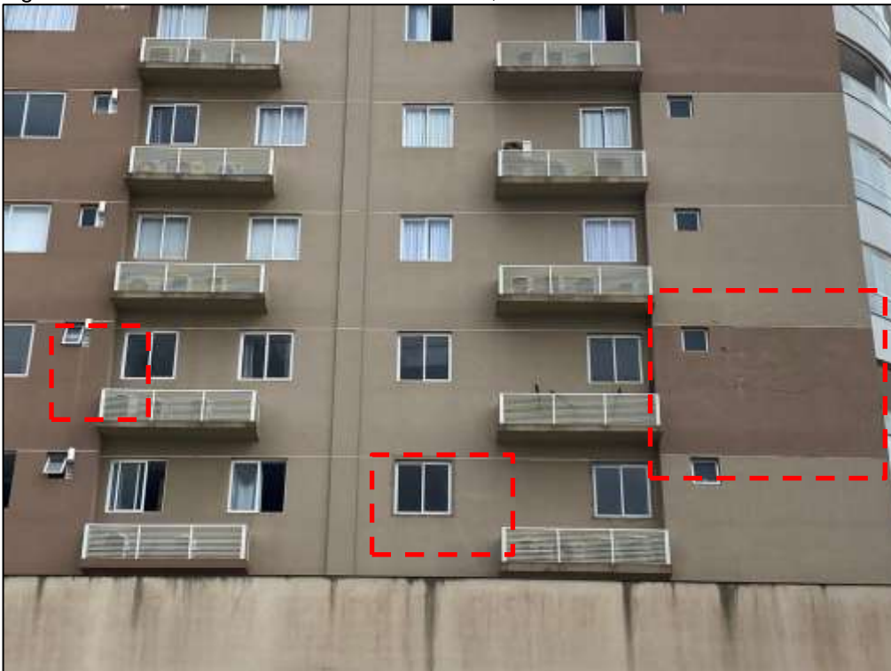
Figura 129: Fachada – retrabalhos executados, fissuras e manchamentos.
