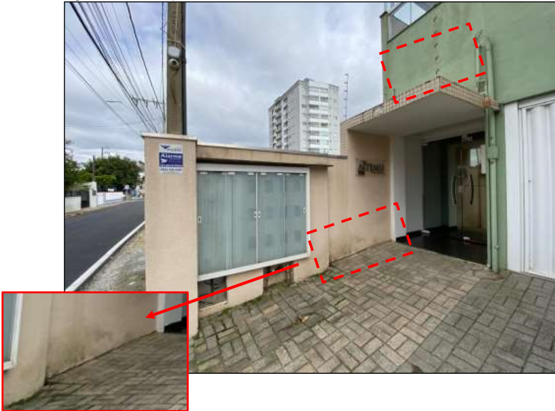
Figura 60: Acesso pedestres – manchamento e fissuras.
