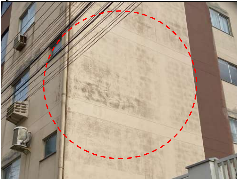
Figura 31: Fachada – manchamentos e fissuras.
