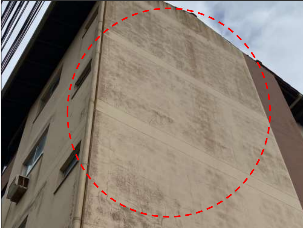
Figura 29: Fachada – manchamentos e fissuras.
