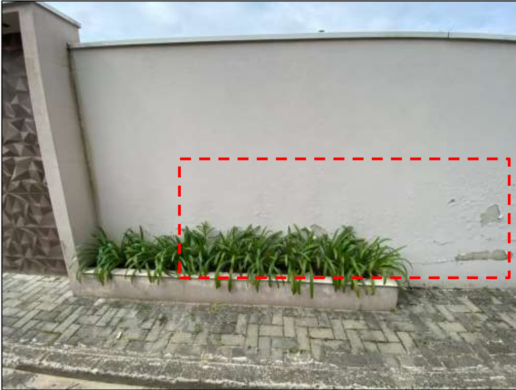
Figura 83: Fachada – descascamento pintura.
