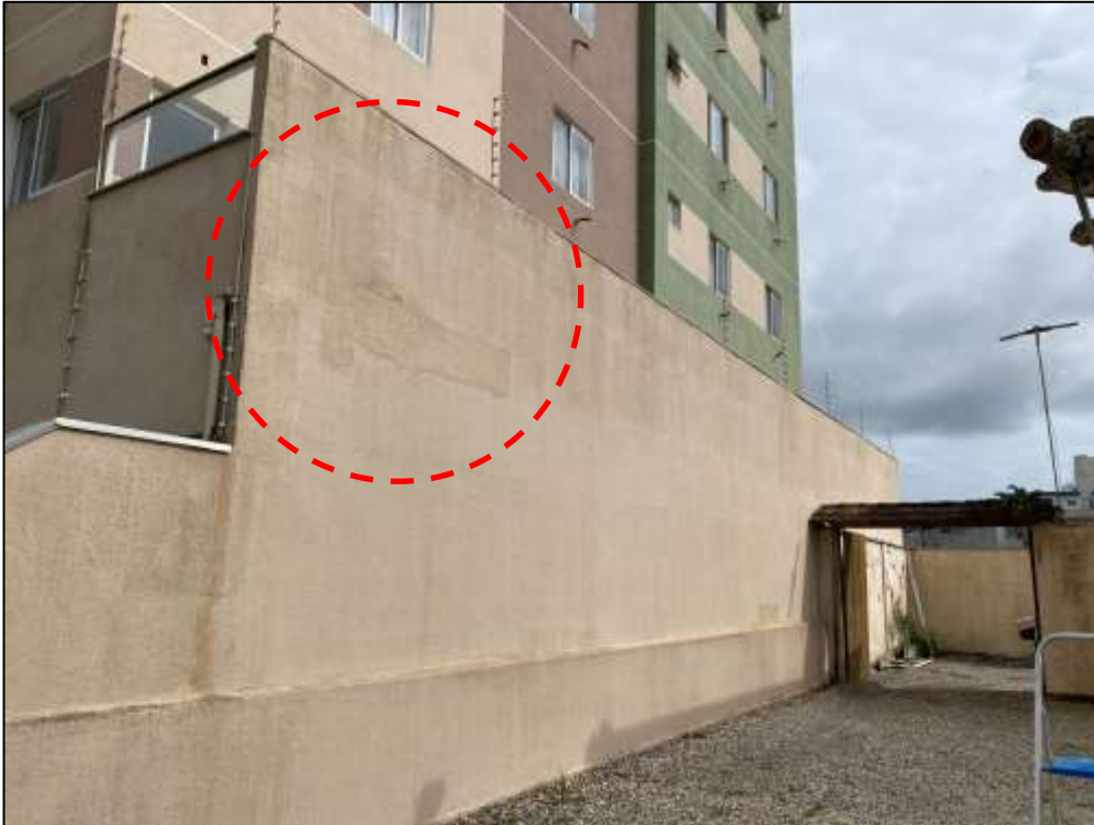
Figura 56: Fachada embasamento – manchamento e fissuras,
