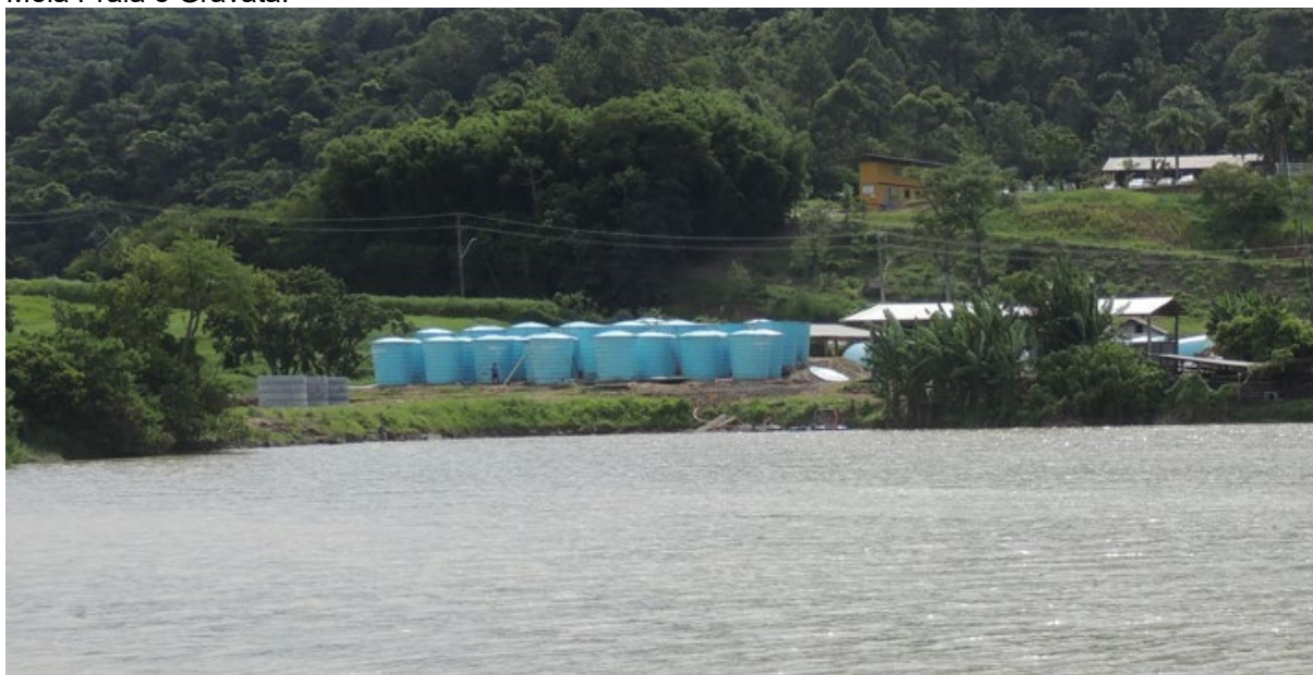
FIGURA 9 – Imagens da Estação de Tratamento de Água (ETA) Pedreiras que abastece os bairros Meia Praia e Gravatá.
