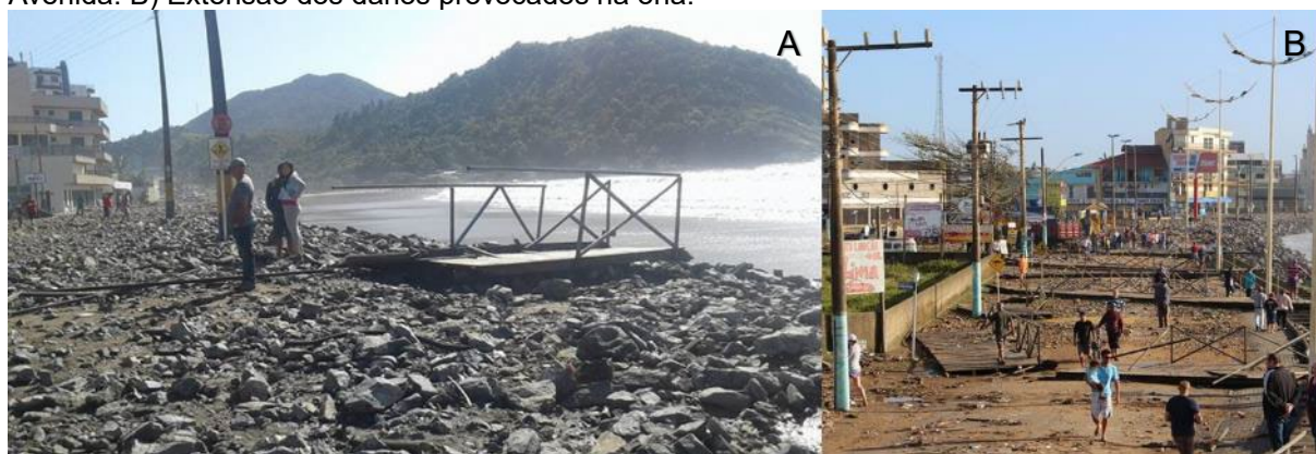
FIGURA 30 – Danos provocados na orla do Gravatá na ressaca ocorrida em novembro de 2016. A) Estrutura do deck de madeira completamente destruída e material do enrocamento arremetido para a Avenida. B) Extensão dos danos provocados na orla.
