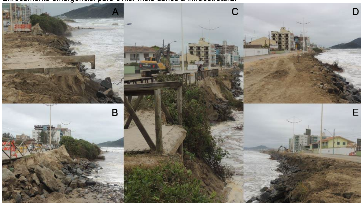
FIGURA 31 – Danos provocados pela ressaca de setembro de 2017. A e B) Danos provocados à estrutura do deck. C) Danos provocados na estreita faixa de restinga remanescente. D e E) Enrocamento emergencial para evitar mais danos à infraestrutura.
