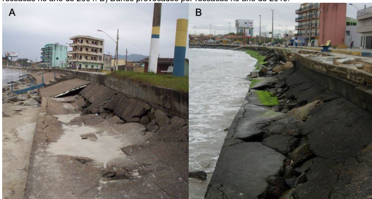
FIGURA 25 – Muro de contenção (sea wall) instalado no ano de 2003. A) Danos provocados por ressacas no ano de 2004. B) Danos provocados por ressacas no ano de 2010.
