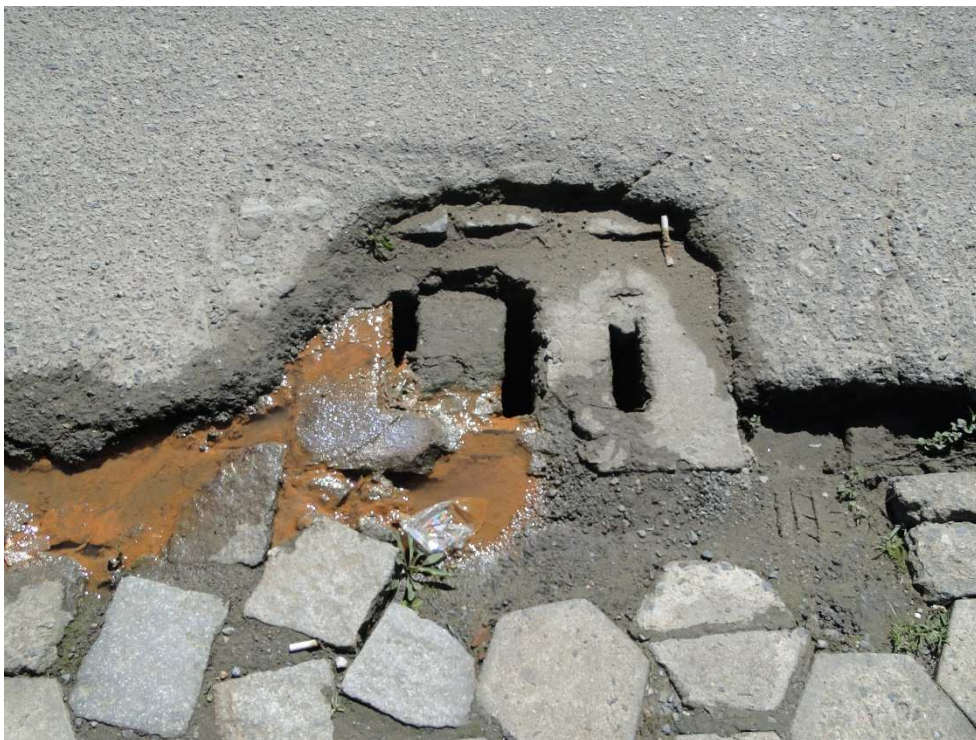
Figura 42: Boca de lobo na rua Orlando Ferreira.
