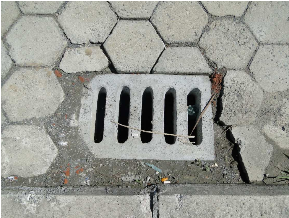
Figura 43: Boca de lobo em rua pavimentada recentemente.
