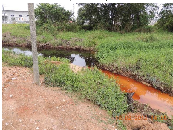
Imagem 6: Sistema de drenagem pluvial do empreendimento conectado à vala existente na frente dos terrenos, que posteriormente é interligada à galeria instalada paralela à BR 470.
