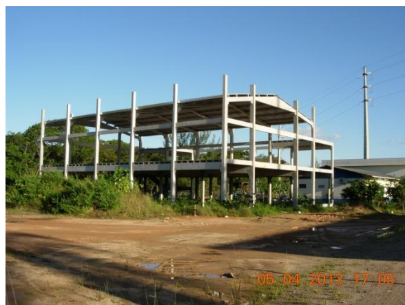
Figura 20: Obras da nova sede da APAE. Foto: João Paulo Gaya. Acervo pessoal.
