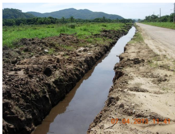
Figura 26: Vala de drenagem à céu aberto localizada na Rua Honório Bortolatto. Foto: João Paulo Gaya. Acervo pessoal.
