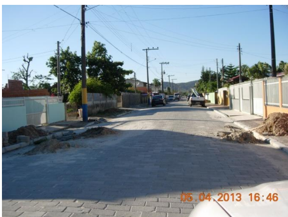
Figura 17: Rua passando por obra de pavimentação e instalação do sistema de drenagem pluvial.
