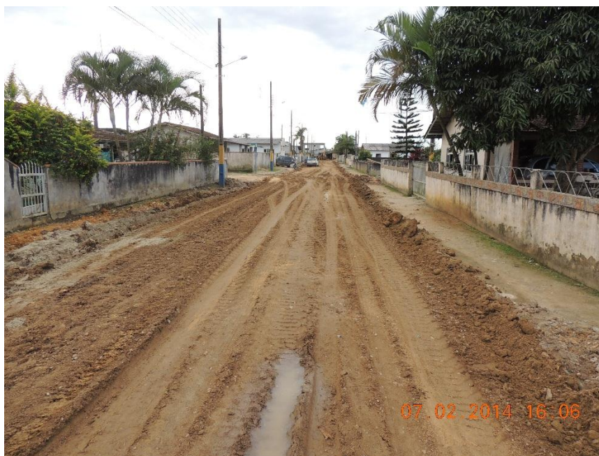
Figura 4.1.5: Obra de pavimentação da Rua Inácio A. Vieira. Foto: João Paulo Gaya. Acervo pessoal.
