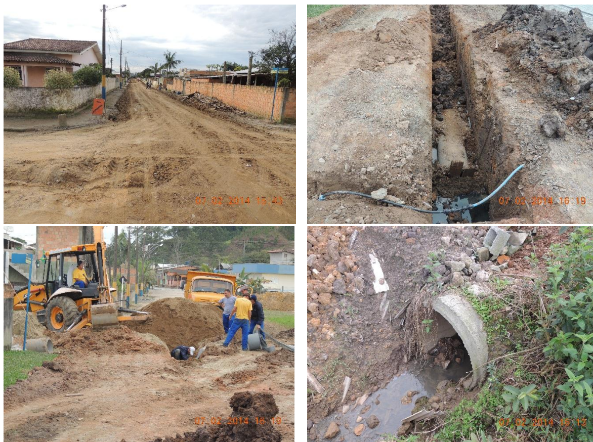
Figura 5.2.1: Obras de pavimentação de ruas e instalação de rede de drenagem pluvial.
