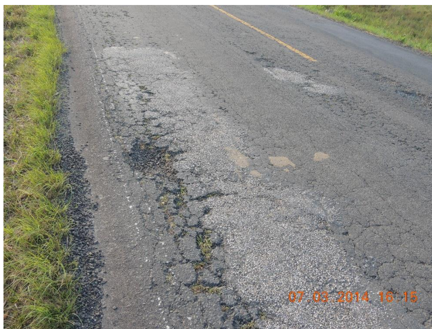
Figura 4.2.4: Avarias no asfalto da SC 413. Notar ausência de acostamento.
