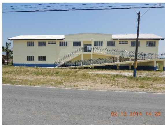
Imagem 20: Obra da creche do Bairro Volta Grande. Foto: João Paulo Gaya. Acervo pessoal.
