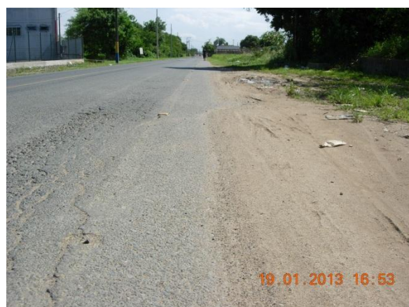
Figura 30: Ciclovia existente na Rua Jornalista Rui A. Rodrigues. Notar falta de manutenção.
