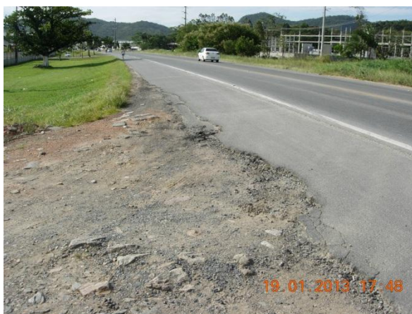
Figura 23: Segundo acesso. Notar a falta de pavimentação e diferença para com o acostamento da Rodovia. Foto: João Paulo Gaya. Acervo pessoal.
