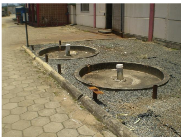
Figura 17: Sistema de tratamento de esgoto. Foto: Eduardo Celezinski. Acervo pessoal.
