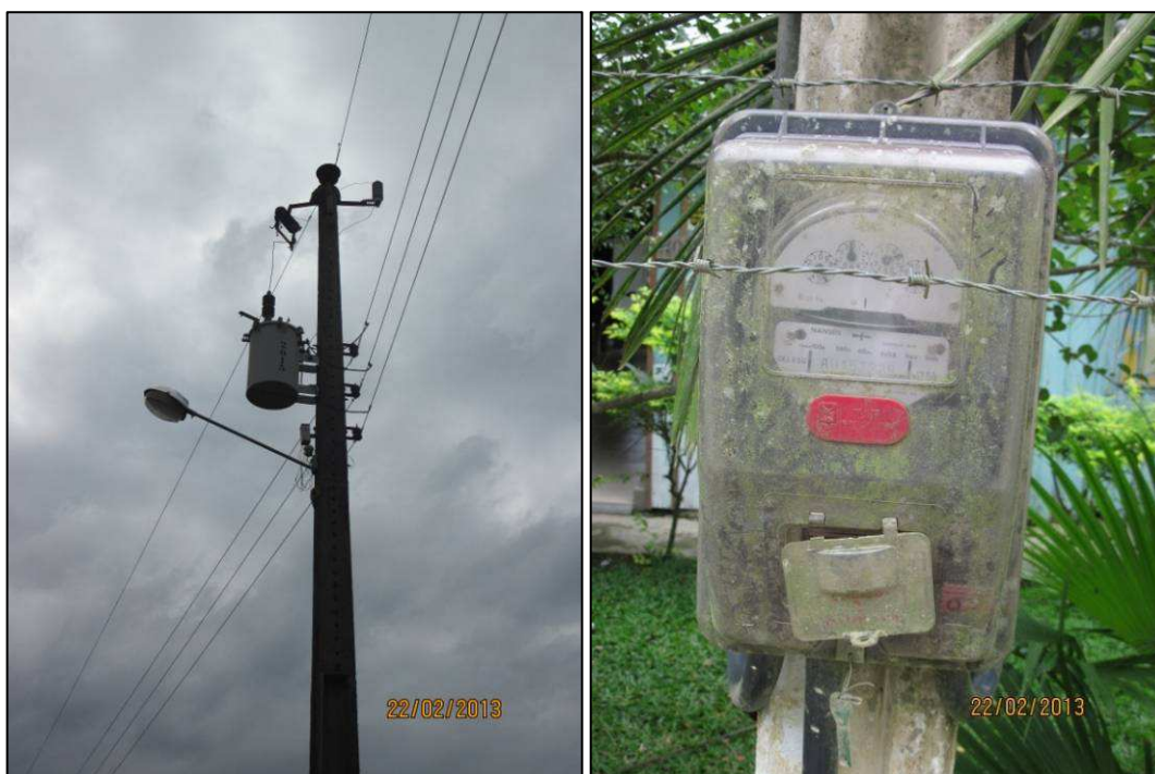
Figura 82- Rede de distribuição de energia à esquerda e medidor de luz a direita.
