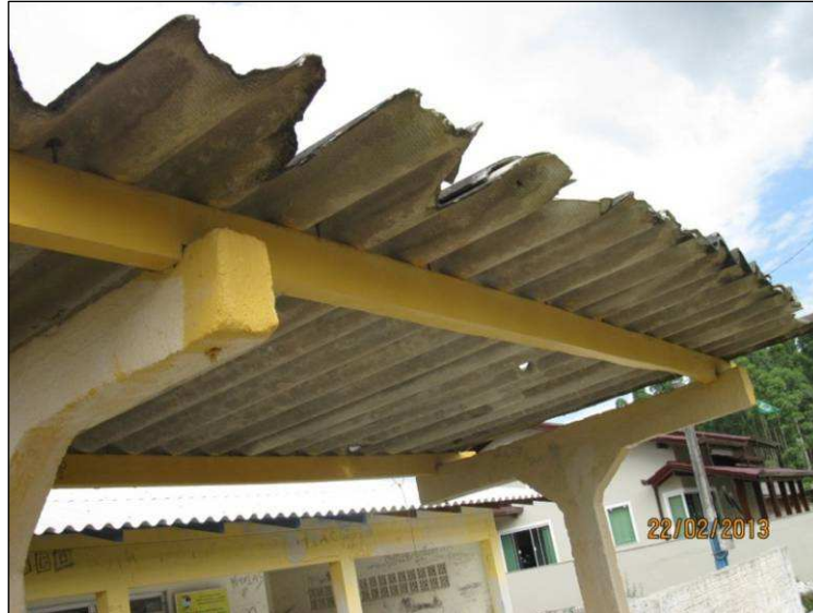
Figura 13- Destaque para o telhado danificado.
