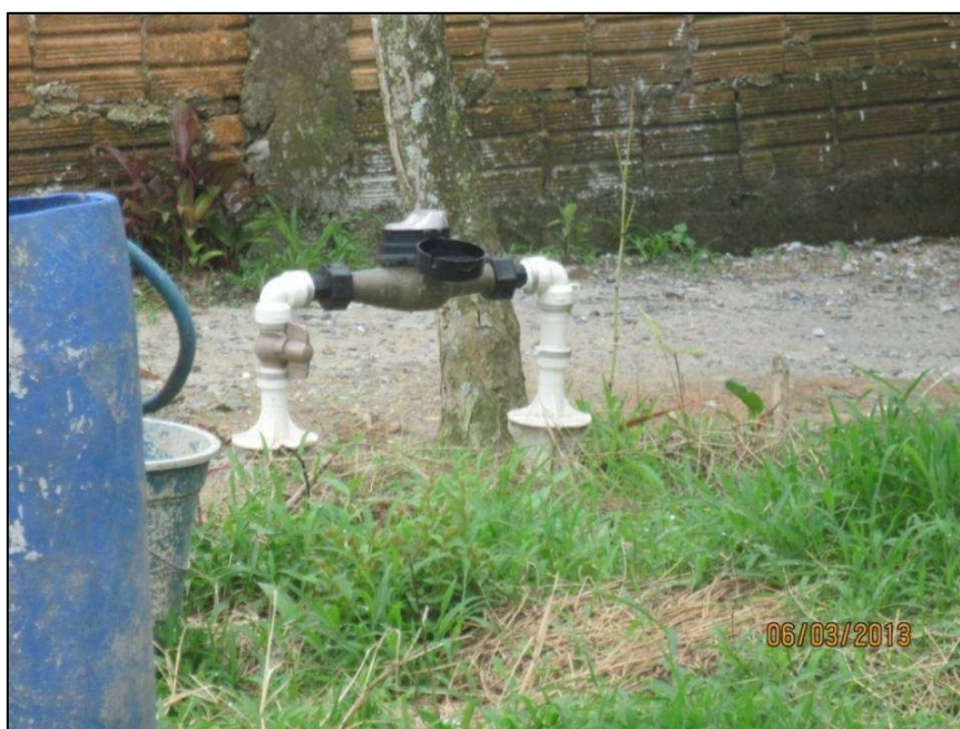
Figura 80- Registro medidor de água, indicativo da distribuição de água potável no bairro Porto Escalvados.
