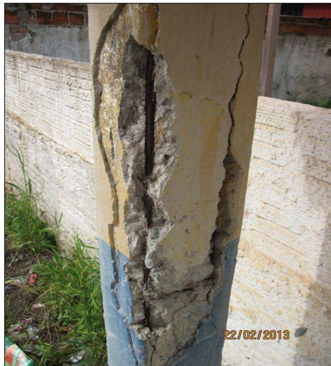
Figura 14- Destaque para coluna danificada.
