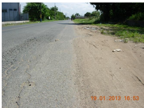
Figura 30: Ciclovia existente na Rua Jornalista Rui A. Rodrigues. Notar falta de manutenção.
