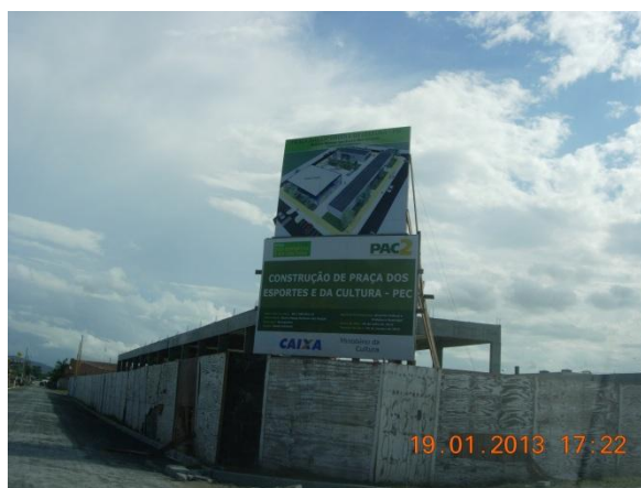
Figura 28: Construção da Praça dos Esportes e da Cultura – Bairro Nossa Senhora das Graças.
