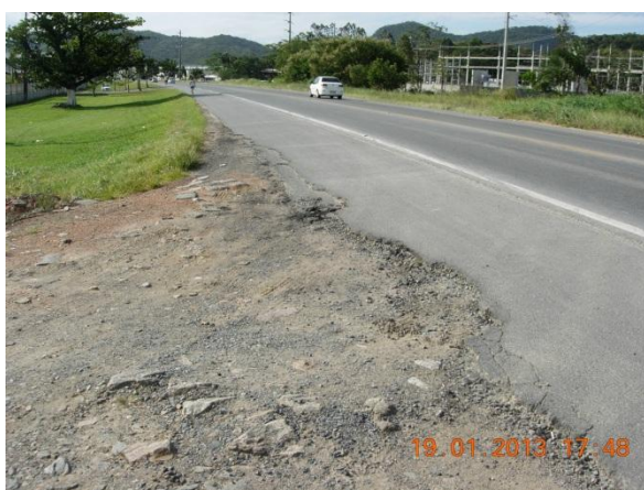
Figura 23: Segundo acesso. Notar a falta de pavimentação e diferença para com o acostamento da Rodovia. Foto: João Paulo Gaya. Acervo pessoal.
