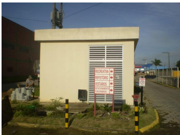
Figura 15: Sistema gerador de energia elétrica. Foto: Eduardo Celezinski. Acervo pessoal.
