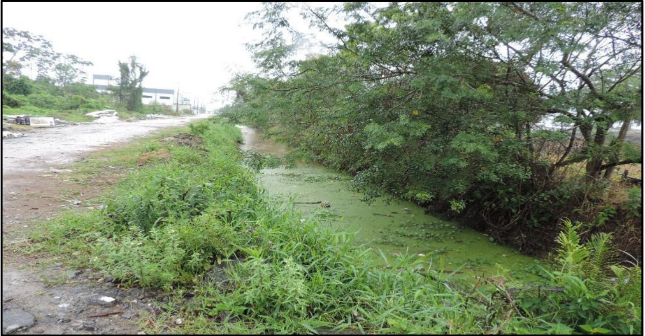
Figura 26: Valas na marginal da Rua Francico de Paula Seara, que funcionam como sistema de drenagem atualmente.
