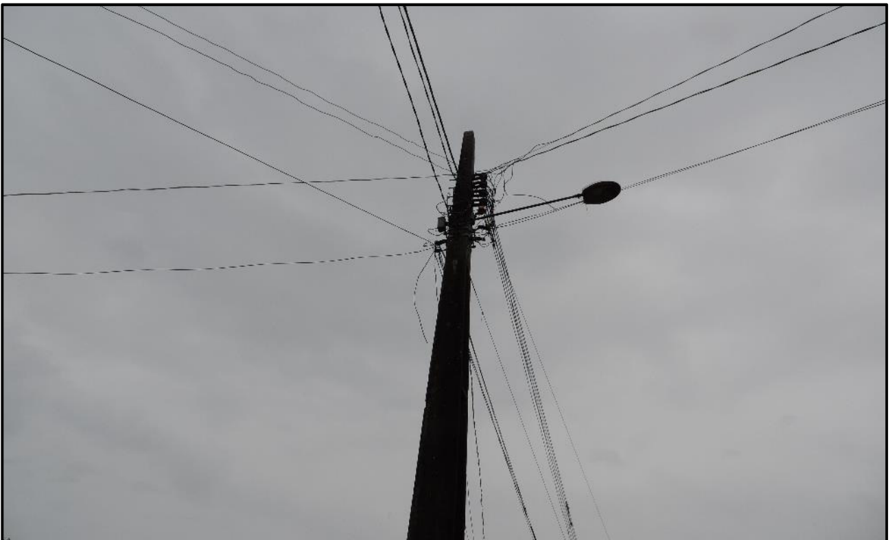
Figura 37: Vista da rede de transmissão de energia na AID.
