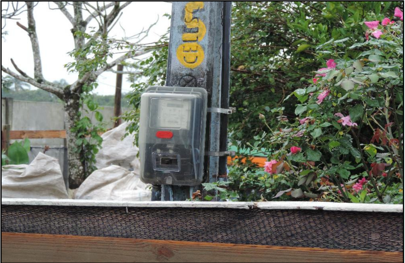
Figura 38: Medidor de energia da Celesc, em residências da AID.
