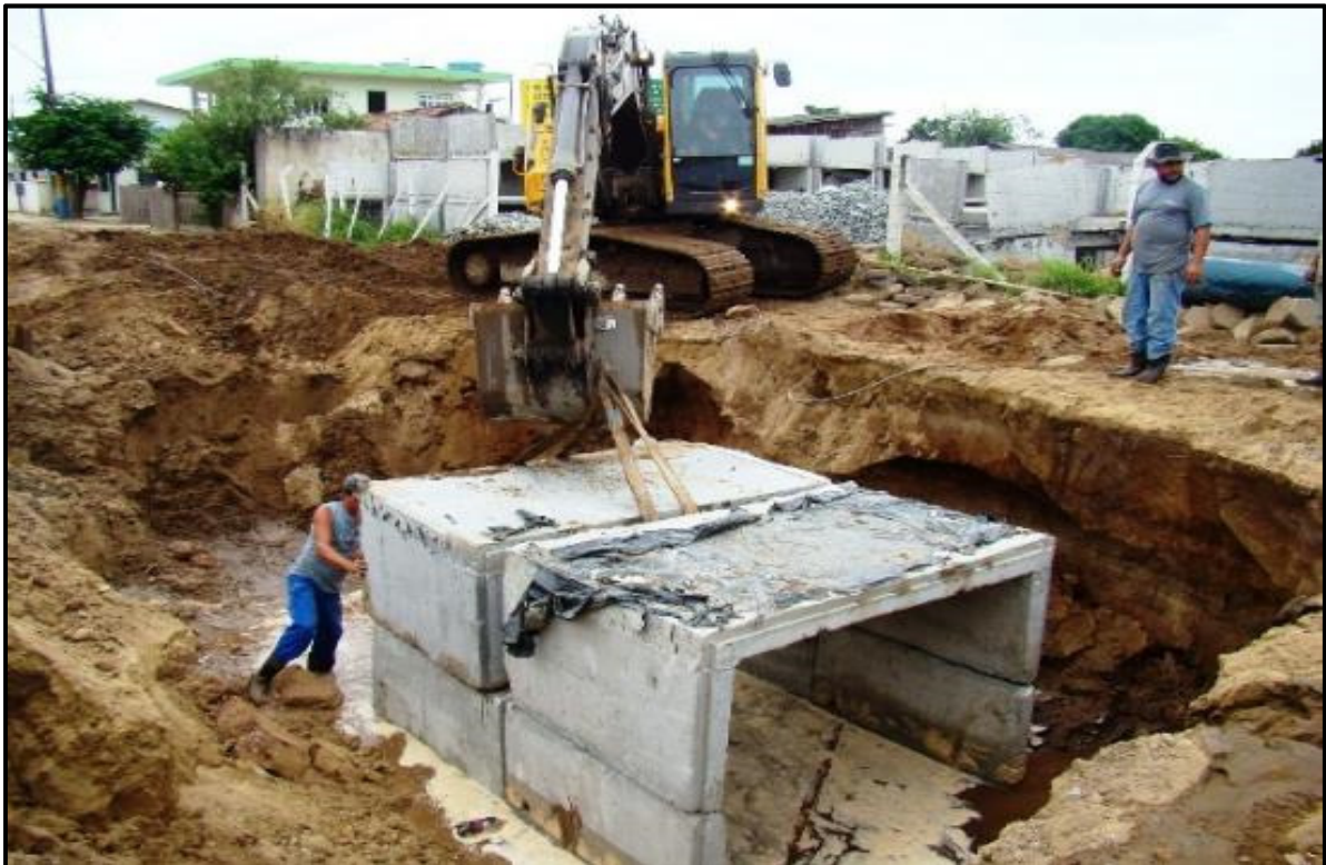
Figura 21: Implantação do sistema de macrodrenagem pluvial na Rua Francisco de Paula Seara, em 2011. Fonte: Notícias da Prefeitura Município de Navegantes.
