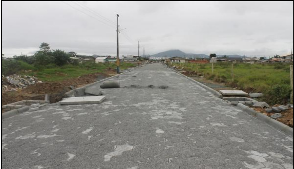
Figura 22: Implantação de pavimentação e sistema de drenagem pluvial de diversas Ruas Bairro São Paulo, em 2016. Fonte: Notícias da Prefeitura Município de Navegantes.
