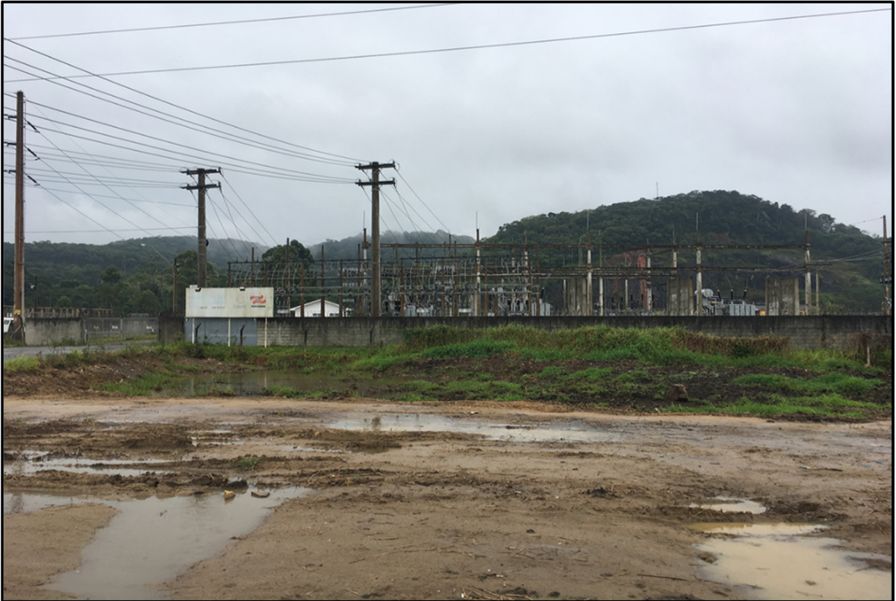
Figura 34: Substação da Celesc, localizada nas margens da BR 470, no município de Navegantes.
