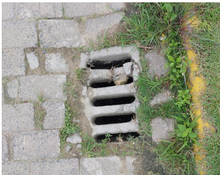
Figura 82. Boca de lobo na Rua Germano Lemos. Data 15/09/2021.
