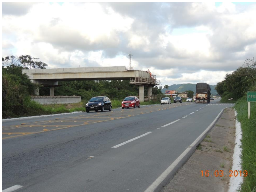
Figura 11: Tráfego de veículos nas imediações do trevo de acesso à SC 414. Notar viaduto em fase de instalação.
