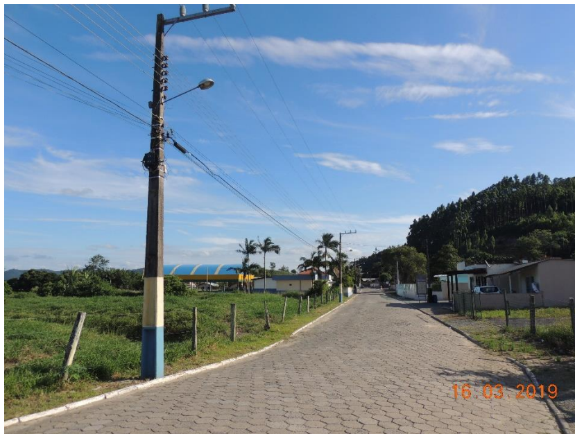
Figura 39: Rede de alta e baixa tensão e iluminação pública no trecho urbano do núcleo Hugo de Almeida.
