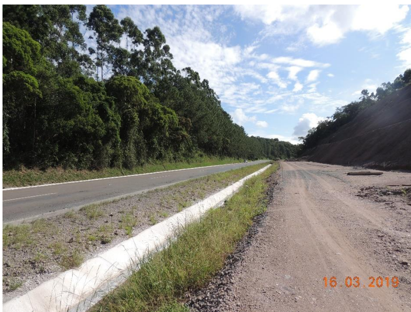
Figura 33: Detalhe da calha instalada entre as pistas da Rodovia BR 470.
