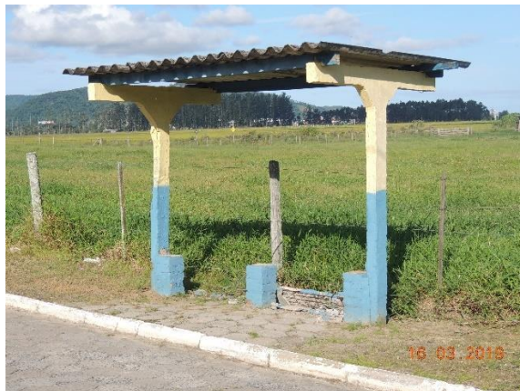
Figura 53: Abrigo de passageiros localizado no Núcleo Hugo de Almeida. Estado de conservação demanda manutenção.
