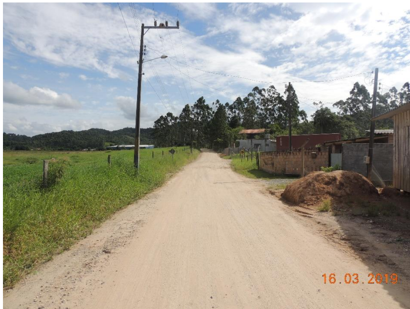
Figura 37: Rede de alta e baixa tensão e iluminação pública no trecho urbano do Bairro Escalvado inserido na AID.
