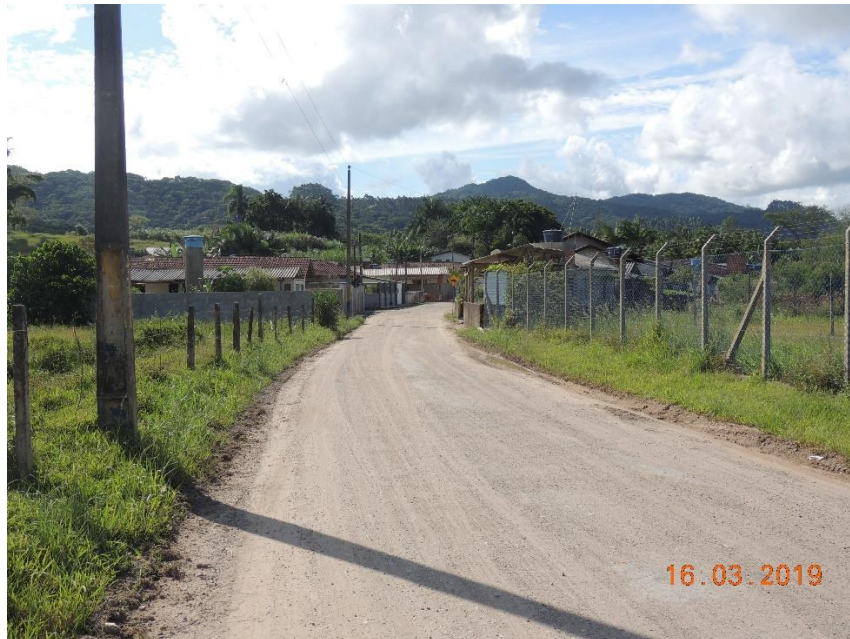
Figura 14: Ausência de pavimentação e passeios para pedestres e ciclistas na Rua Teresa de Souza.
