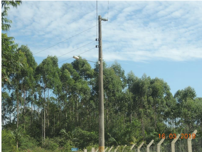
Figura 38: Redes de baixa tensão (monofásica) e iluminação pública em trecho do Bairro Escalvado.
