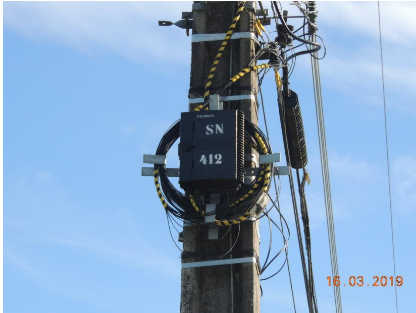
Figura 42: Detalhe dos equipamentos de banda larga da Fibratech em poste no Núcleo Hugo de Almeida.
