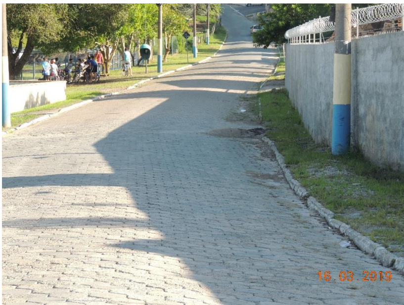
Figura 83: Ausência de revestimento nos passeios para pedestres na Rua Tancredo Neves.
