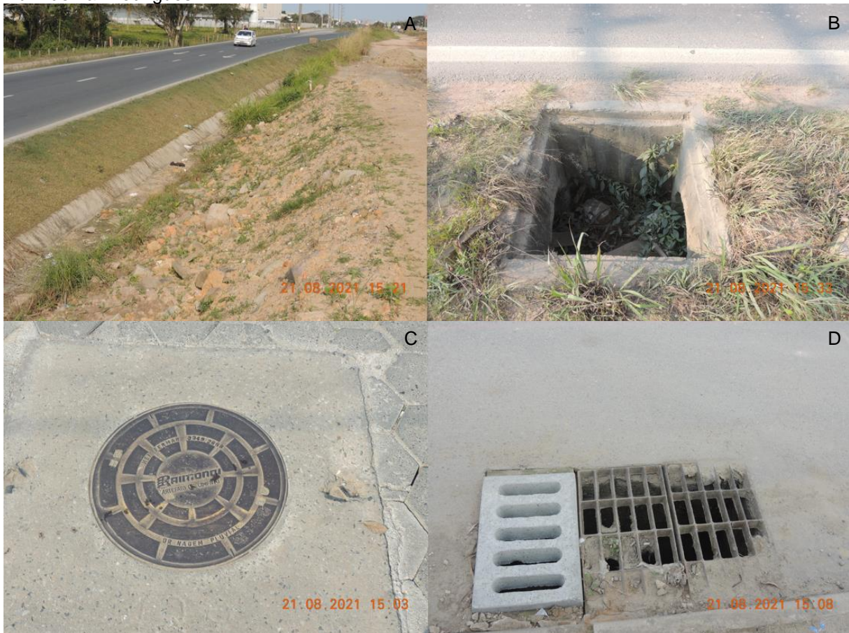
FIGURA 4 – Drenagem pluvial da AID. A) Meia calha instalada na marginal Norte da Rodovia BR 470. B) Caixa de passagem instalada na marginal Sul da BR 470. C) Tampa de acesso ao sistema de drenagem pluvial da Rua Vereador Celso A. dos Passos. D) Grelhas de boca de lobo na Rua Jornalista Rui Ademar Rodrigues.
