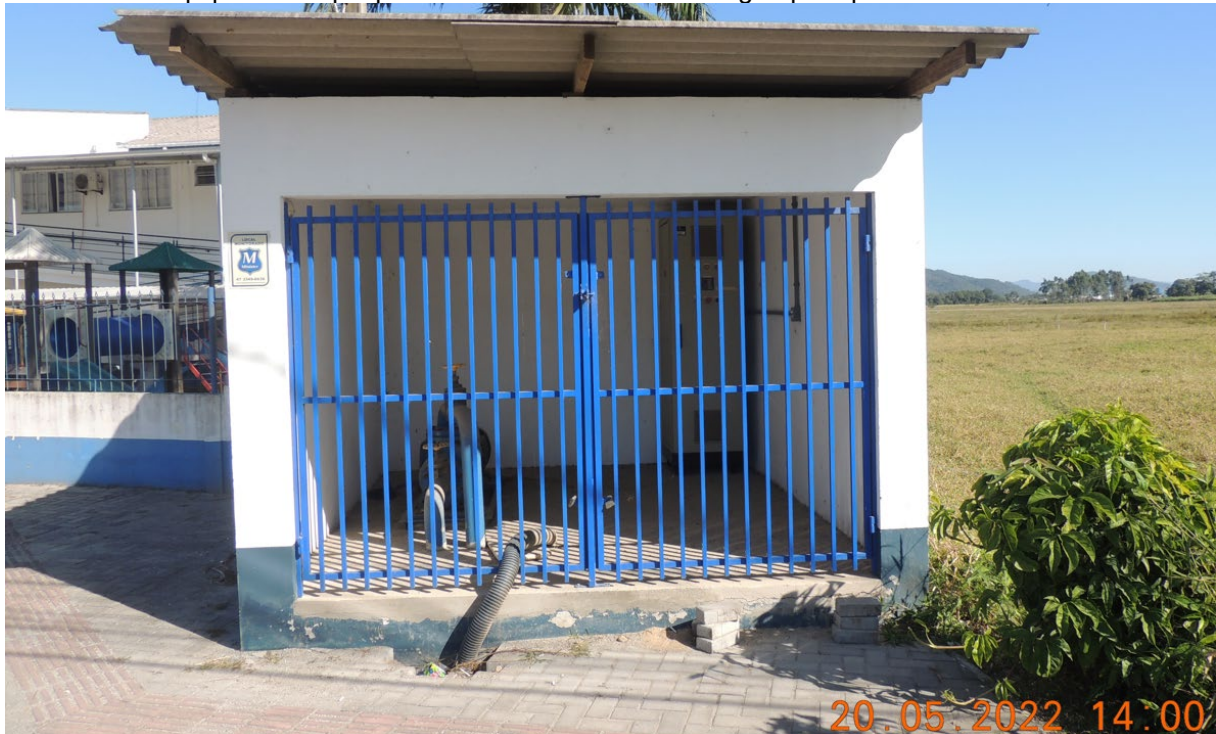
FIGURA 7 – Equipamento que promove o bombeamento de água para parte do Bairro Volta Grande.
