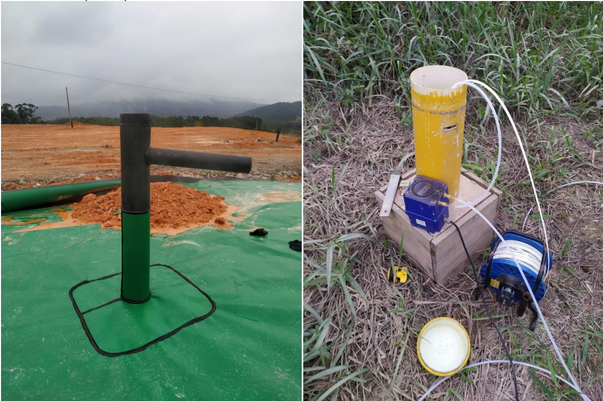
Figura 36: Controles Ambientais – Dreno de gases (esquerda) e poço de monitoramento das águas subterrâneas (direita).
