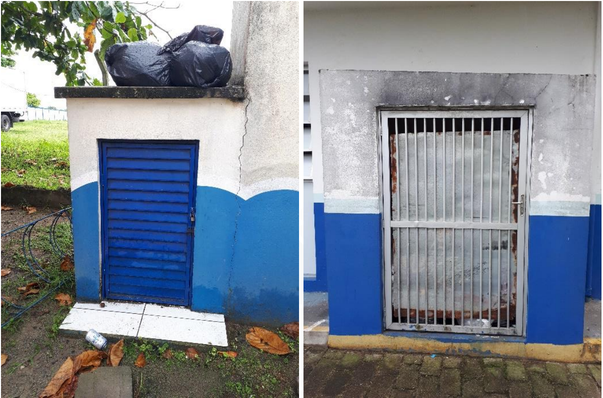
Figura 42: Abrigos externos sem identificação dos resíduos armazenados e com problemas de conservação.
