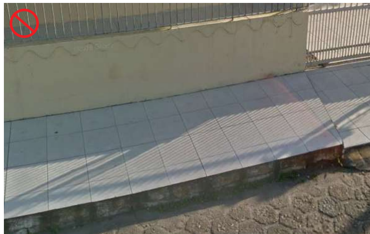
Piso derrapante (piso cerâmico)
